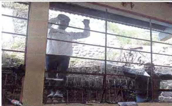
Foto7: Sustitucion de vidrios en ventanales de metal por deterioro
